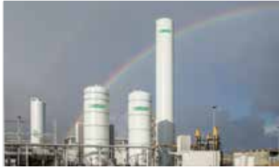
Stabilimento di Porto Torres, Sassari Italia
